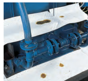
Вокруг машинного оборудования для сбора протечек
